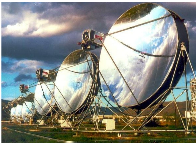
Рисунок 42 - Солнечная электростанция тарельчатого типа
