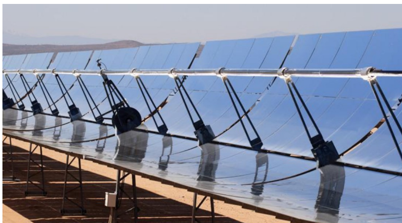
Рисунок 43 - Солнечная электростанция с параболическими концентраторами
