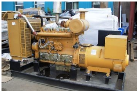
Рисунок 10. Внешний вид дизель-генераторной установки
