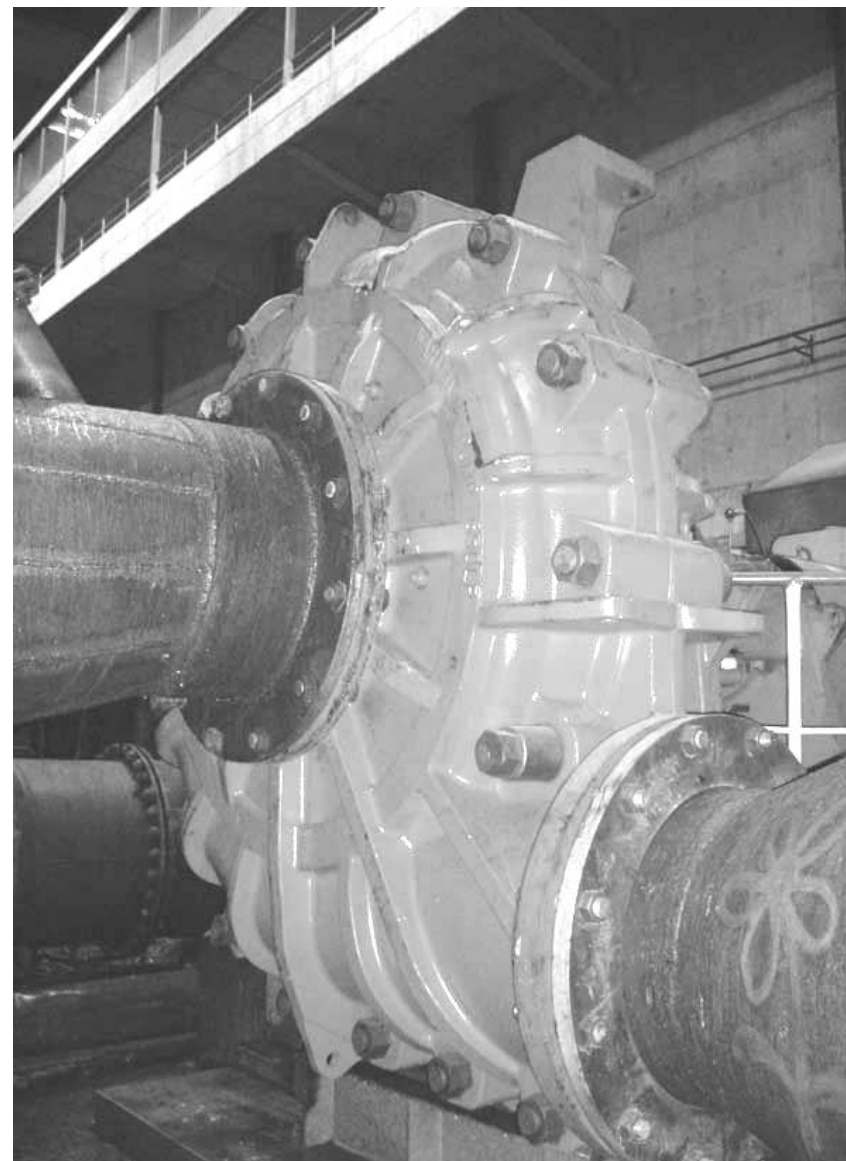
Рис. 14.3. Установка грунтовых насосов в пульпонасосной станции
